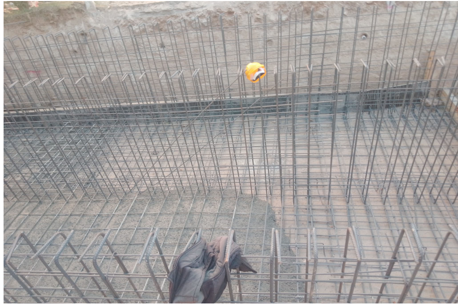
Fotoğraf 28. Balçova Hacı Ahmet Deresi Islah Çalışması (Yerinde dökme kapalı betonarme kapalı kesit yapılması)
