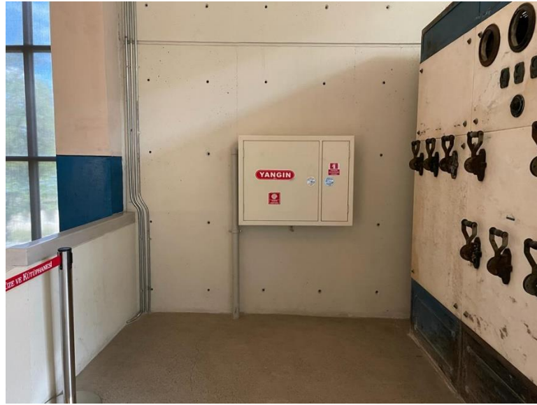
Şekil 122. Müze İç Mekânından, Elektrik Santrali Özgün Makineleri, Beton Perde Üzerine Monte Edilen Yangın Sistemi ve Sıva Üstü Yol Alan Elektrik Sistemi Örneği (Kişisel Arşiv)
