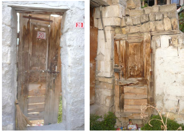
Resim 99: Yapının Günümüzde Yıkılmak Üzere Olan Arka Avlu Kapısı
